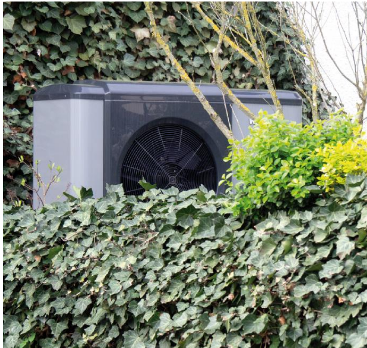
Luft-Wasser Wärmepumpe in einem Garten
